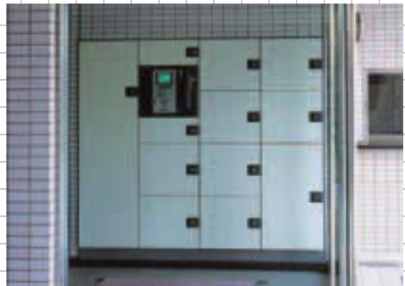
宅配ボックス
